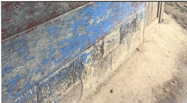
Fotografía 3: Se observan las paredes de block inconclusas, por lo que se repararán para poder mejorar la condición en la que los estudiantes desarrollan el proceso de enseñanza y aprendizaje.
