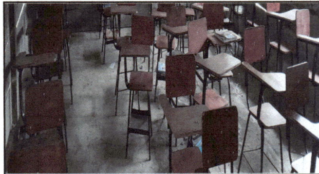
Fotografía 4: Se observa la necesidad de reparar el piso de torta de concreto del aula.
