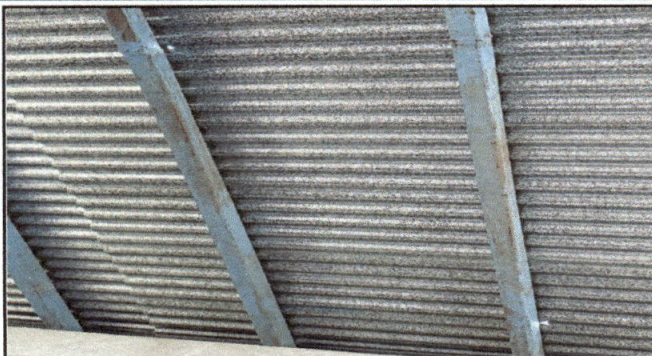
Fotografía 1: Fotografía del techo del edificio escolar de dos aulas, que requiere reparación de estructuras metálicas y sustitución de láminas acanaladas a troqueladas.
